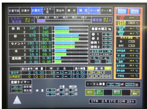
写真-2 プラントの制御画面
